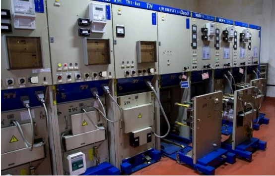
Ячейки высоковольтного оборудования
